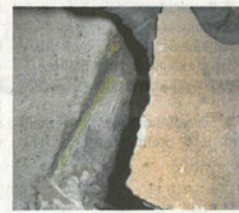
Die Risse im Stein sorgen in der Gemeinde für große Sorge.
